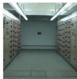
电力监控设备
